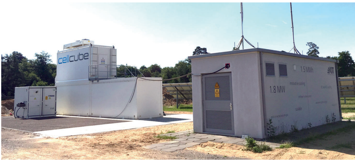
Redoxfluss- und Lithiumionengroßspeicher am Karlsruher Institut für Technologie, Campus Nord, für Feldversuche im EnergyLab 2.0.
